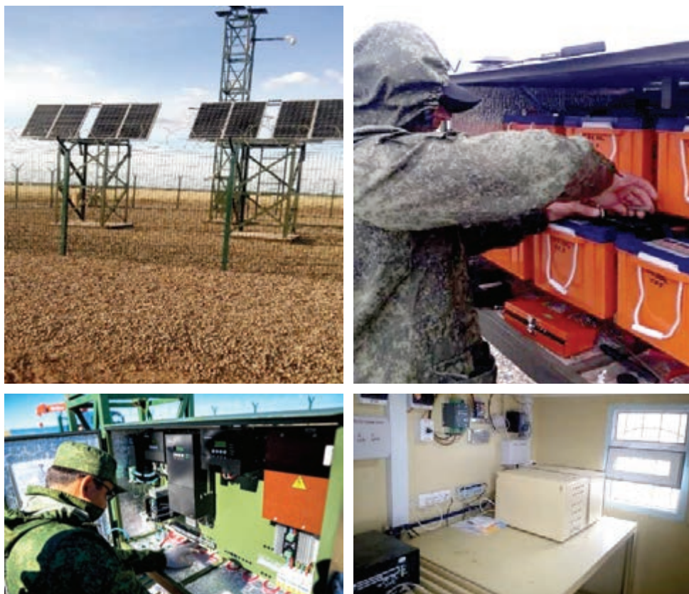
Рисунок 4.14. Солнечные панели и аккумуляторы автономной системы электропитания
