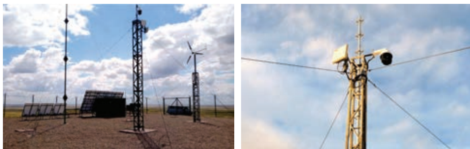
Рисунок 4.12. Мачты с установленными видеокамерами и антеннами передачи данных
