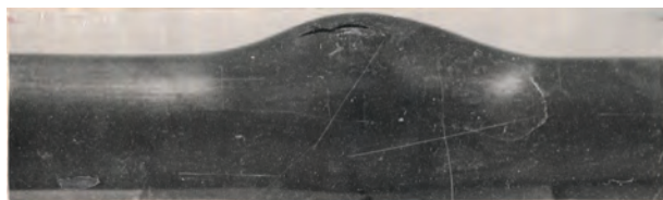
б) вид сбоку на вздутие и разрыв оболочки
