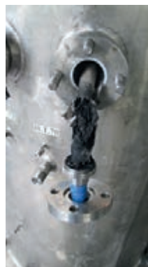
Рисунок 1.7. Состояние удлинительных проводов термопар в разъеме ШР-2
