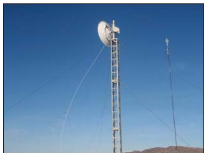
Рисунок 3.241. Антенны, установленные на вершине 1008
