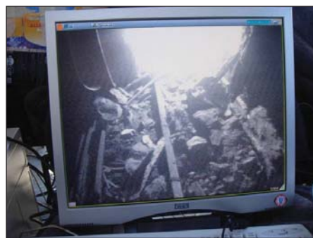
Вид на участок сооружения на мониторе
