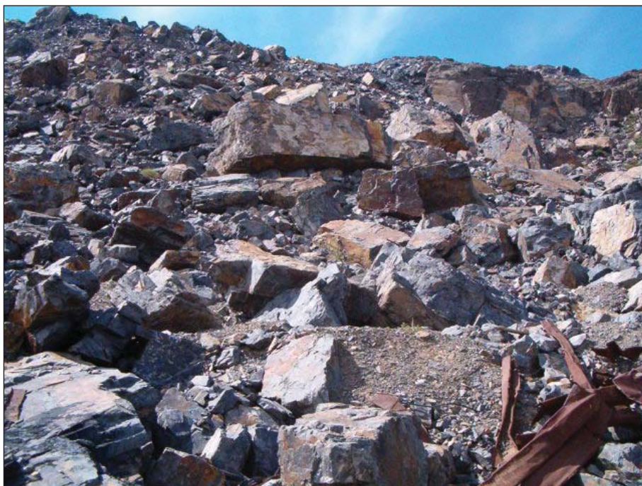
Рисунок 3.94. Навал горной породы над порталом правого сооружения
