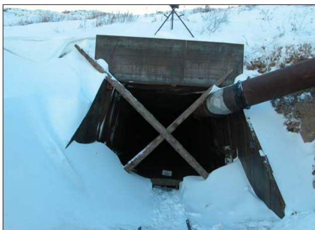
Рисунок 3.135. Вход в инженерное сооружение «У» закрыт
