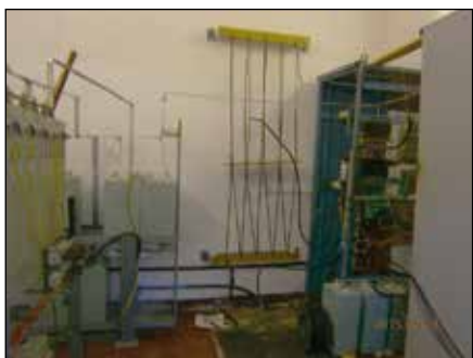
а) слева – высоковольтная конденсаторная батарея, в центре – балластное сопротивление
