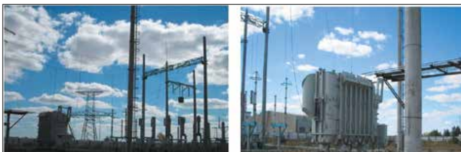
Рисунок 1.33. Подстанция КТМ и главный силовой трансформатор
