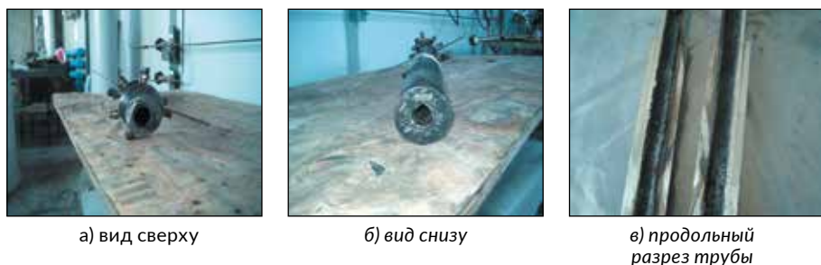
Рисунок 4.62. Состояние внутренней поверхности сливной трубы
