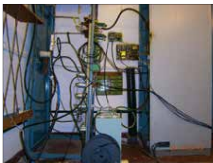
б) сборки силовых элементов в монтажном шкафу
