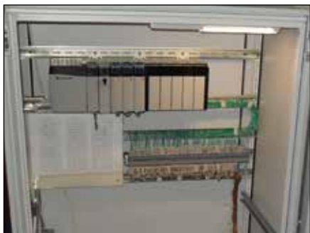
Рисунок 3.46. Шкаф с контроллерами системы САУ
