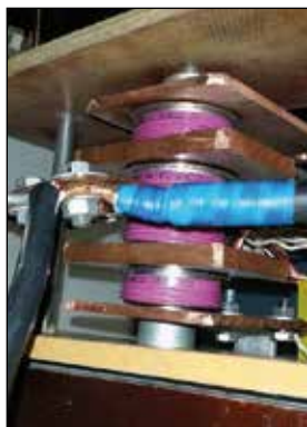
в) сборка мощных тиристоров прямой ветви тока
