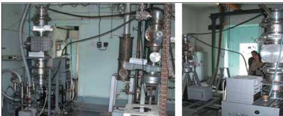
Рисунок 1.35. Оборудование системы высоковакуумной откачки
