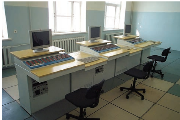
Центральный пульт управления стендовыми системами для экспериментов первой очереди
